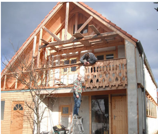
Chez Michel et Anne Sophie - La touche finale : le balcon à motifs, réalisé à l'aide d'un gabarit dessiné par Michel et découpé à la scie sauteuse. ©DR
