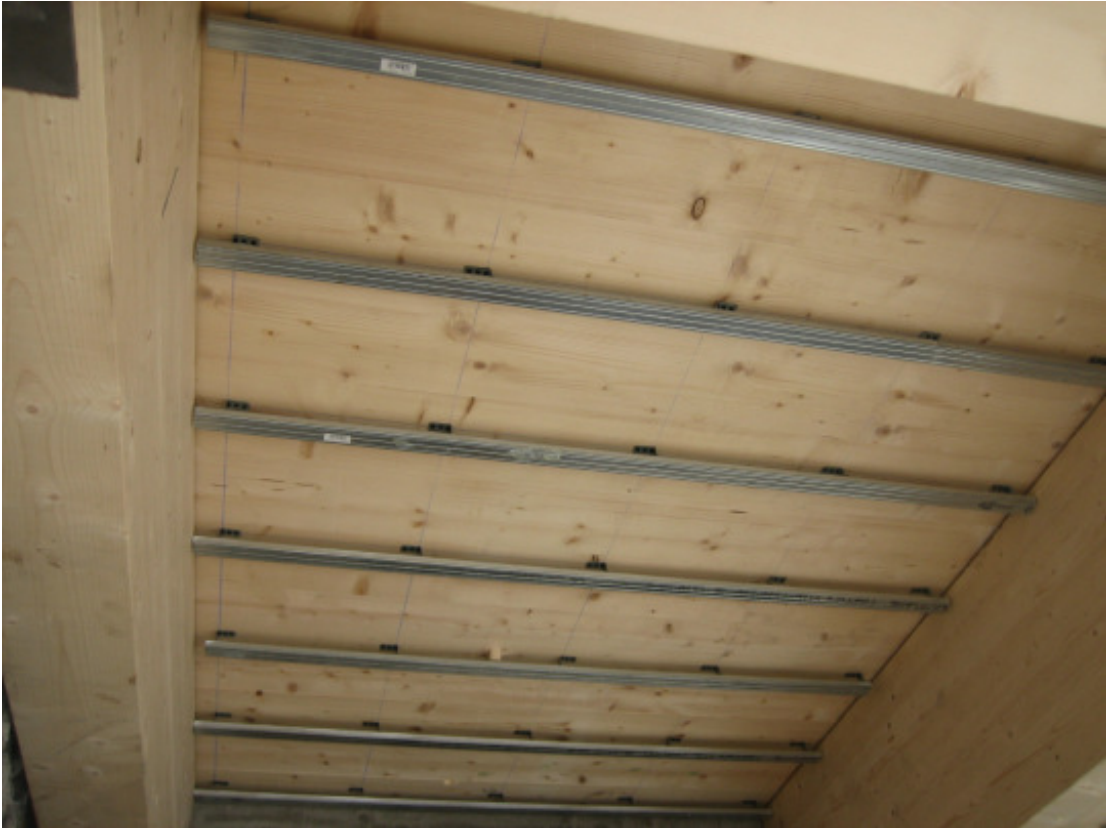
Plancher SUD, Fournures de faux plafond
